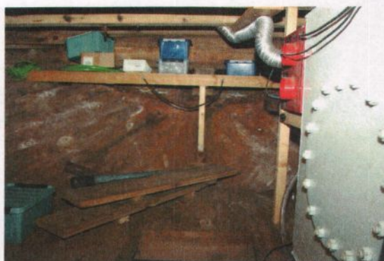
Lagerrom med vanntank
