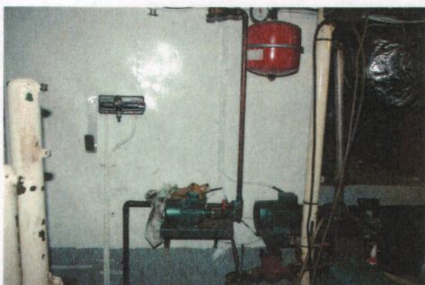
Motorer til pumper, nødbrannpumpe og lenspumpe
