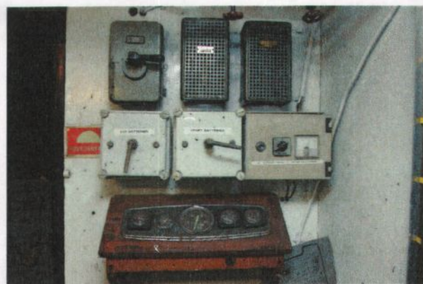
Originalt kontrollpanel (ikke i bruk) og el.brytere
